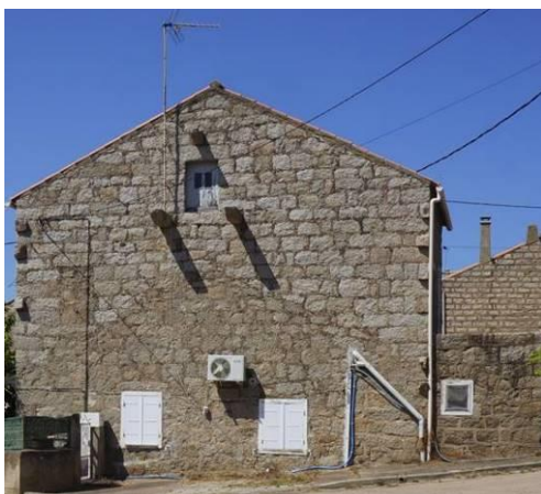
Contre exemple : équipement et goutottes en applique
